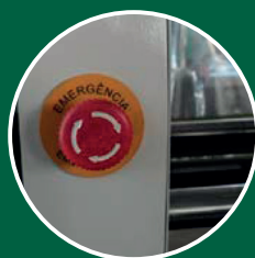
Dois botões de emergência
